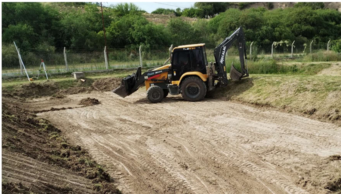
Foto 5: Retroexcavadora trabajando en la limpieza de un estanque. Fuente: G. Dapello – DNA.
